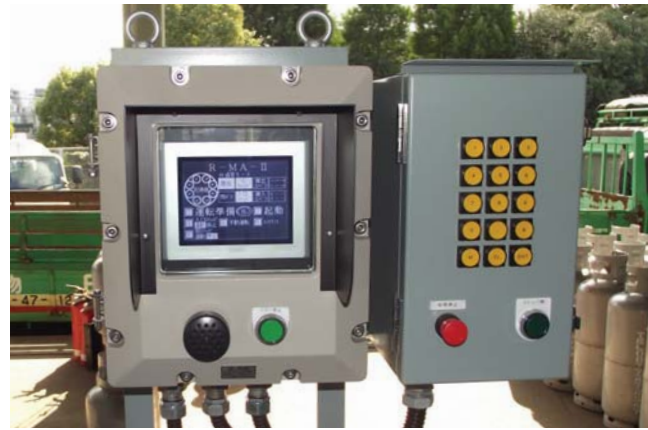
システム全体を一括コントロールできる現場操作盤
