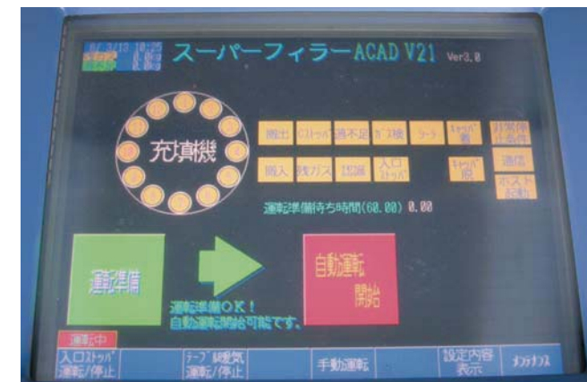
システム全体を一括コントロールできる現場操作盤
